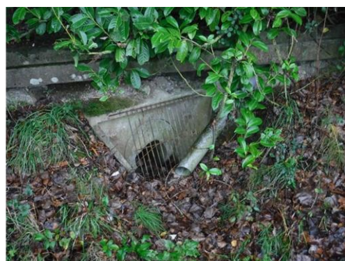
Drain enterré sur le Prieuré
